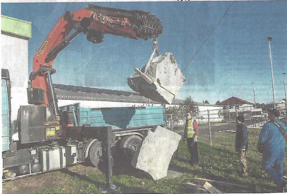
Mühselos hebt der Autokran das tonnenschwere Gestein. Als letzte von sechs Skulpturen wurde gestern die Arbeit von Shinroku Shimokawa an ihren Standort vor der Hans-Michel-Halle in Hemsbach versetzt.
